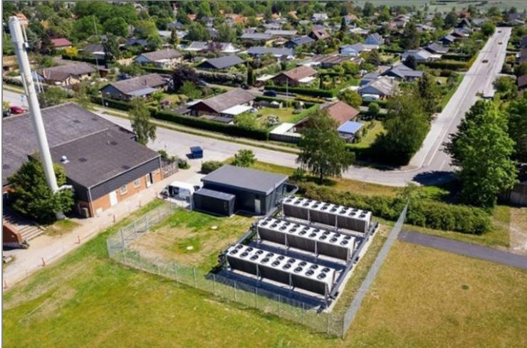
Slagslunde 1,2 MW Quelle: planenergi.dk
